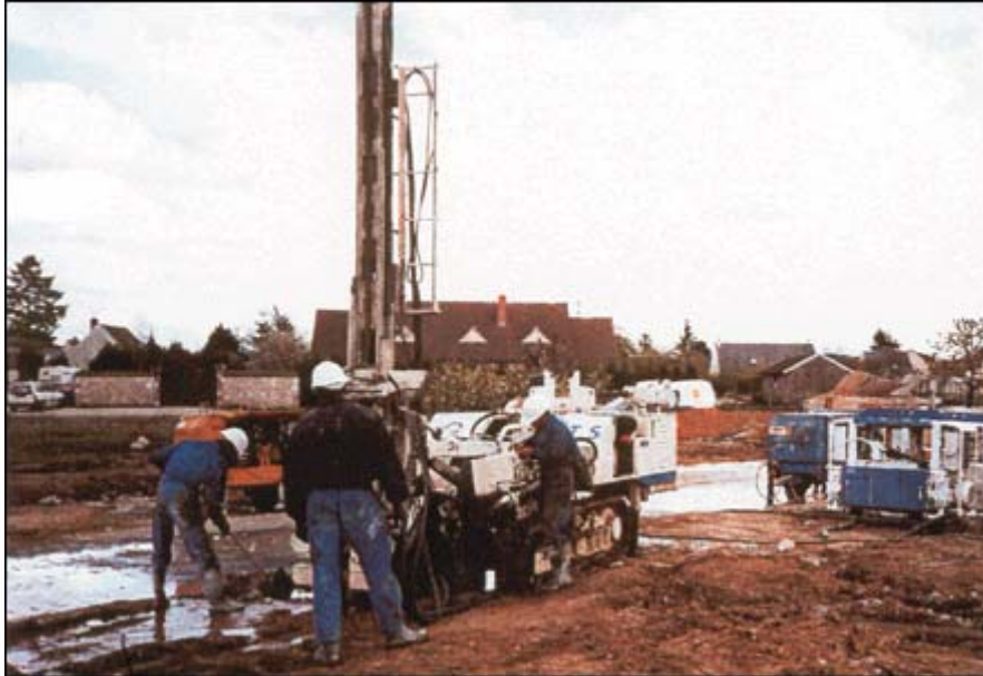
Atelier de forage et pompes d'injection
